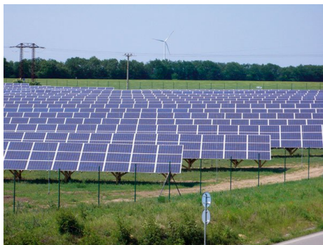
R3-13 Fotovoltaická elektrárna
