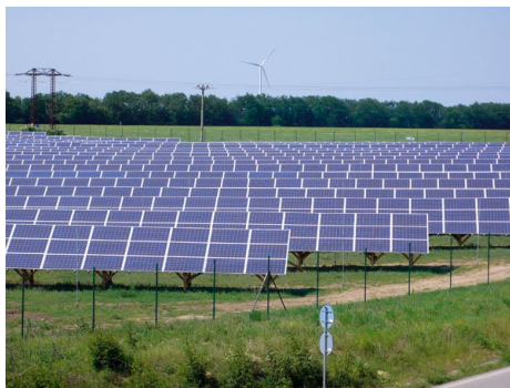
R3-13 Fotovoltaická elektrárna
